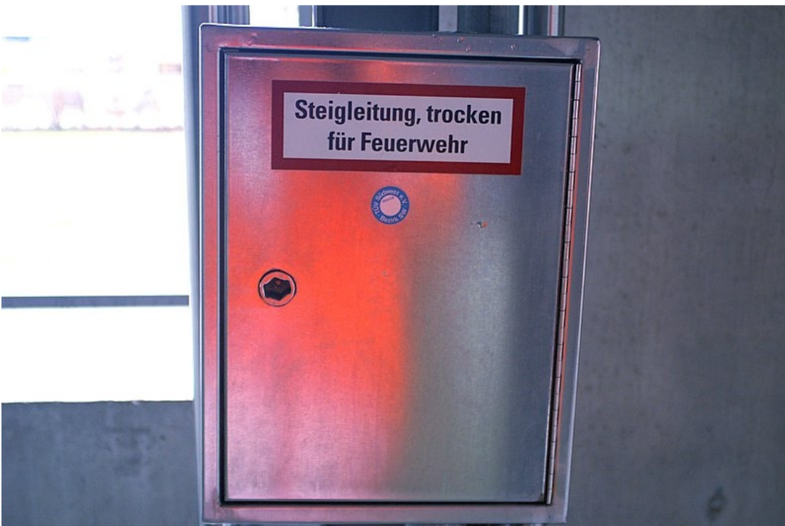
Entnahmeeinrichtung DIN 14461-2 für Löschwasseranlage (Steigleitung) „trocken“ Zukünftige Beschriftung: „Löschwasserleitung, trocken für Feuerwehr“
