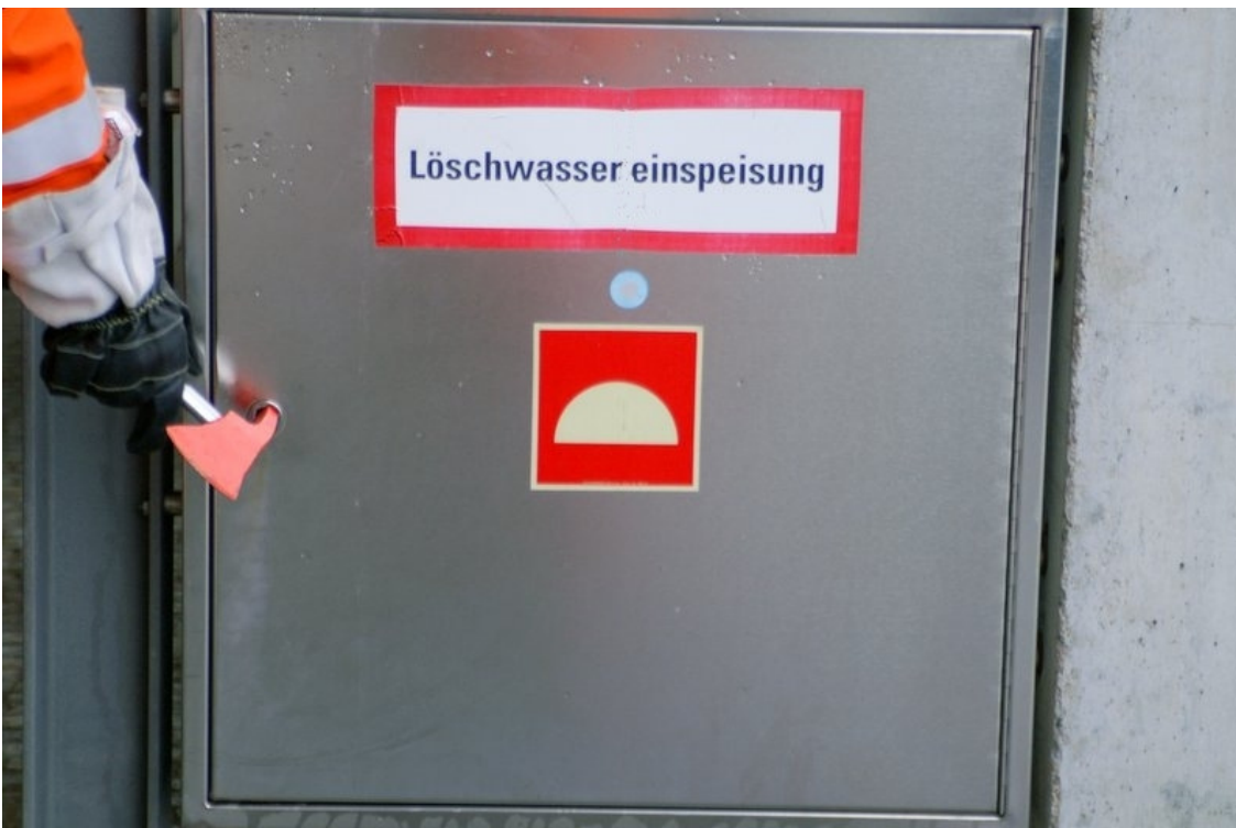
Einspeiseeinrichtung DIN 14461-2 für Löschwasseranlage (Steigleitung) „trocken“
