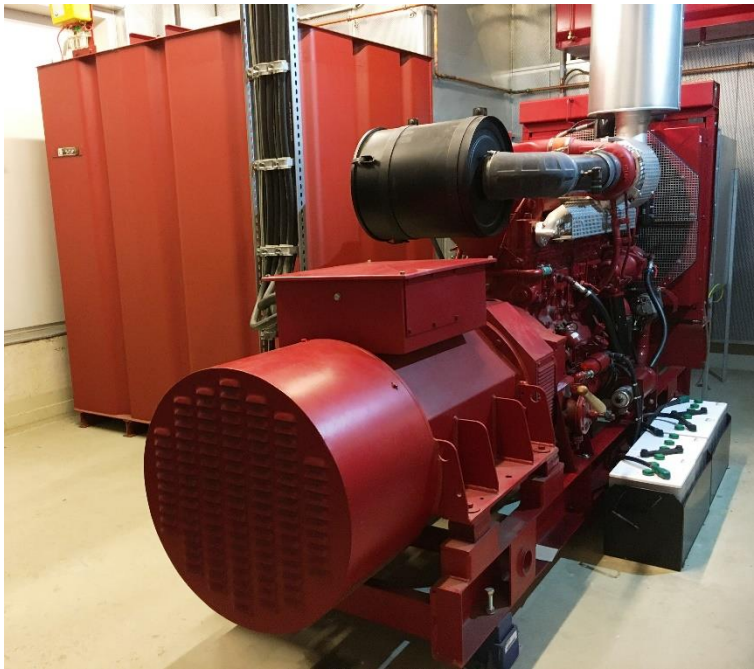
Abb. 1: Hier abgebildet ist eine leistungsfähige stationäre Netzersatzanlage (360 kVA) mit großem Kraftstofftank im Hintergrund. Aufgrund der baulichen Integration in das Gebäude ist ein vollständiger Wetter- und Zugriffsschutz gegeben.
