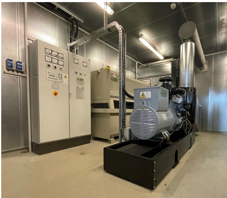
Abb. 2: Bei dieser 100 kVA starken Netzersatzanlage ist die Abführung der Abluft gut zu erkennen. Diese Anlage wurde im Zuge eines Feuerwehrraum-Neubaus realisiert.
