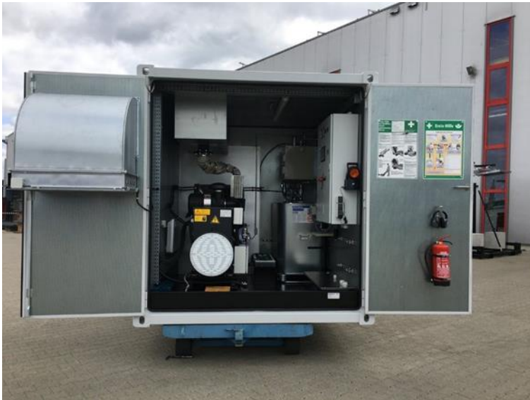
Abb. 6: Innenansicht des 10-Fuß-Containers.
