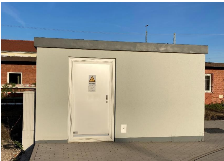
Abb. 7: Hier ist eine Fertigteil-Betonstation zu sehen, wie sie häufig zur Unterbringung von Transformatoren verwendet wird. Auch Netzersatzanlagen können in Betonstationen verbaut werden, so dass ein besonderer Schutz der Anlagen gewährleistet ist. Die Stationen sind in verschiedenen Größen und Ausführungen erhältlich.
