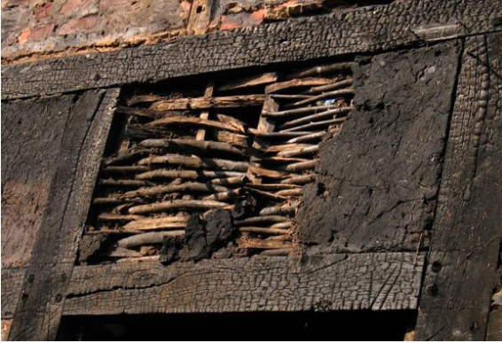
Abb. 5 5 : Durch Brandeinwirkung abgeplatzter Lehm an einer Ausfachung
