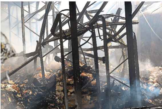
Abb. 13 13 : Durch Hitzeeinwirkung verbogene Stahlträger
