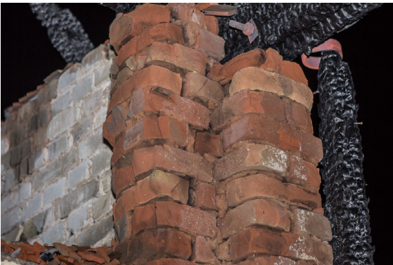
Abb. 77: Durch Brandeinwirkung zerstörte Fugen an einer Mauer aus gebranntem Stein
