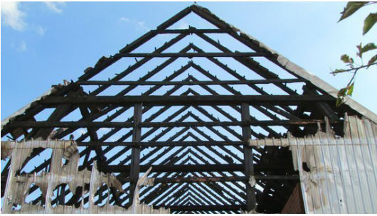
Abb. 4 4 : Abgebrannter aber noch stabiler Dachstuhl
