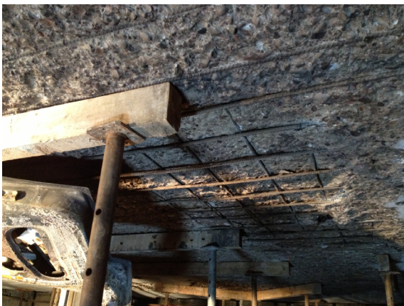
Abb. 11 11 : Durch Brandeinwirkung abgeplatzter Beton mit freiliegender Stahlbewehrung
