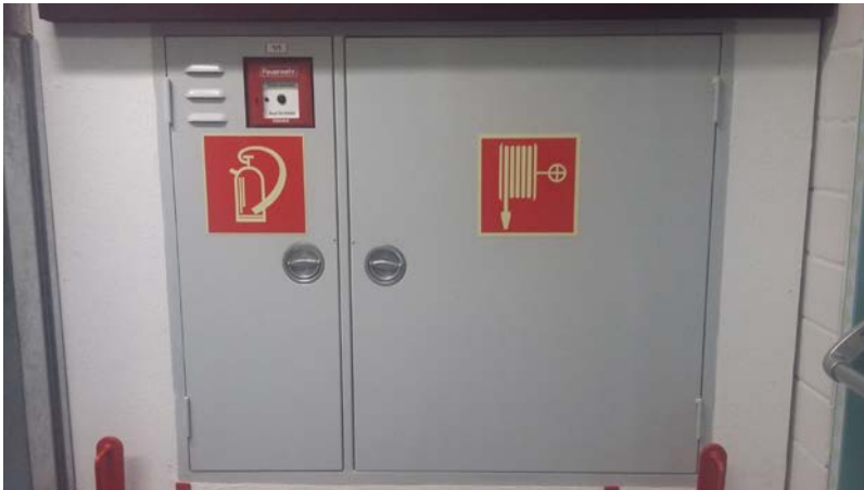
ABBILDUNG 17: WANDHYDRANT TYP F
